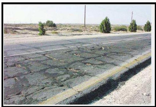
Рис. 1. Дефекты дорожных покрытий
