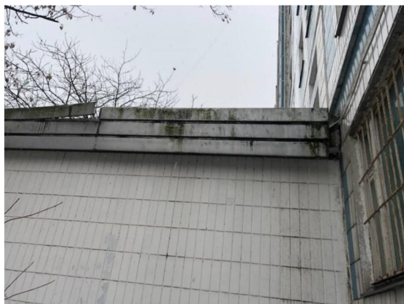
Рисунок 3 - Деформация, поверхностная коррозия ограждения входных групп
