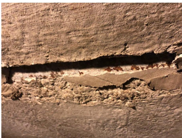
Рисунок 4 - Чердак. Разрушение защитного слоя бетона, оголение арматуры, коррозия плит покрытия
