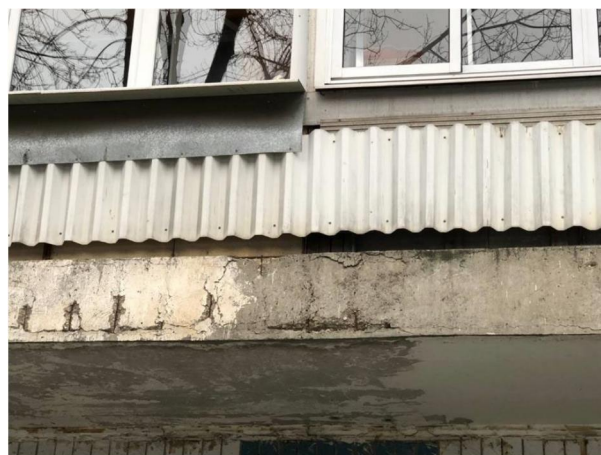
Рисунок 2 - Разрушение окрасочного слоя плит лоджий. Следы замочкания. Разрушение защитного слоя бетона, оголение арматуры, коррозия
