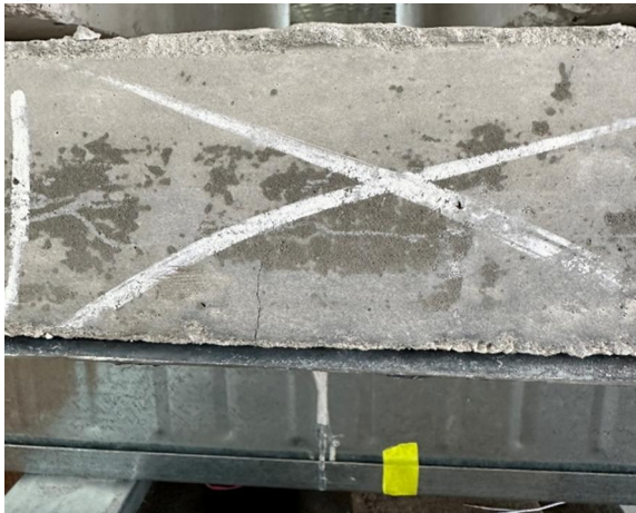
Рис. 10. Вертикальная трещина в теле бетона выше несъемной опалубки при нагрузке 2765 кг/м 2
